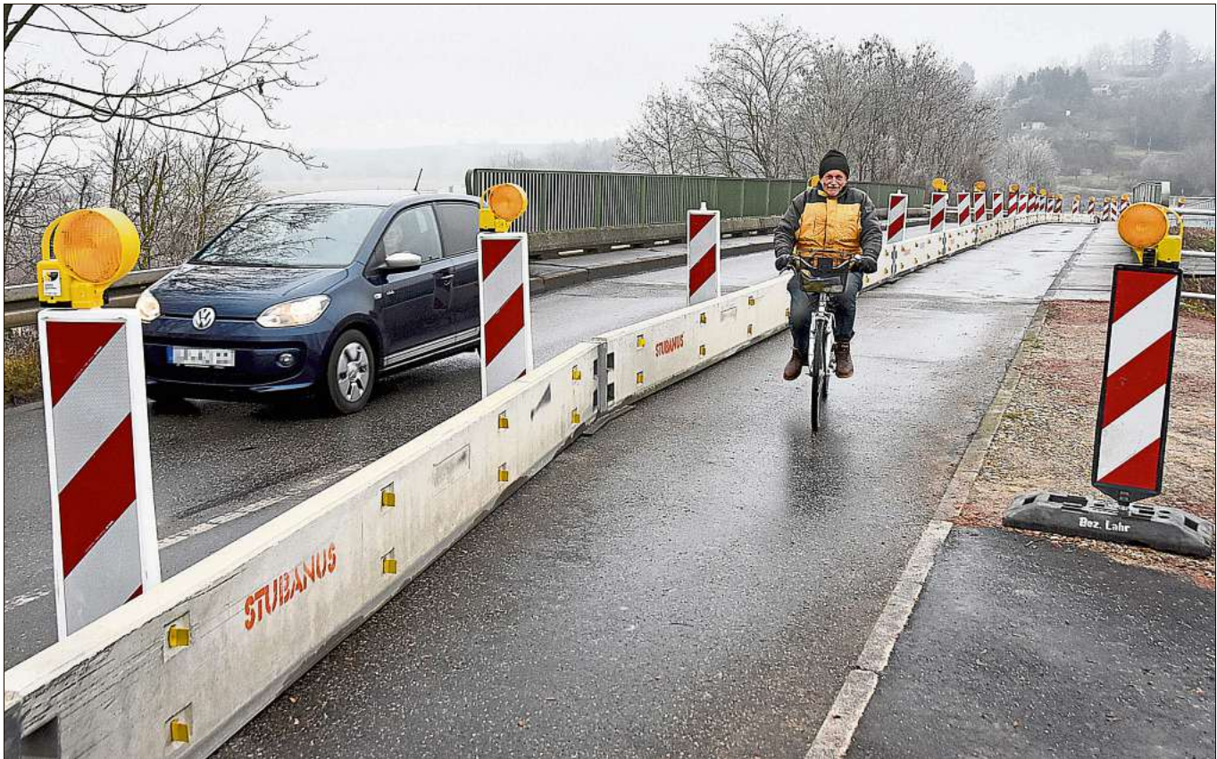
Die Bahnbrücke bei Hugsweiler steht Autofahrern nur noch halbseitig zur Verfügung – aus Rücksicht auf Radler. Foto: Schabel
